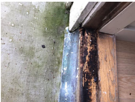
Bilde viser råte i dør.
