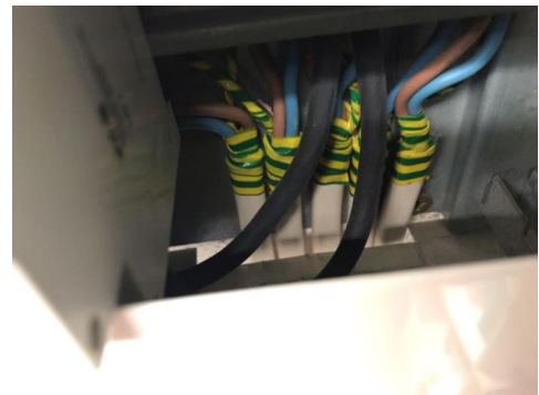
Bildet viser utett sikringskap.
