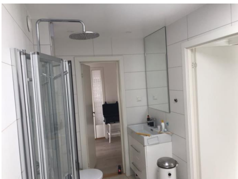
Bildet viser dør i våtsone.
