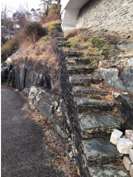
Bildet viser manglende rekkverk.
